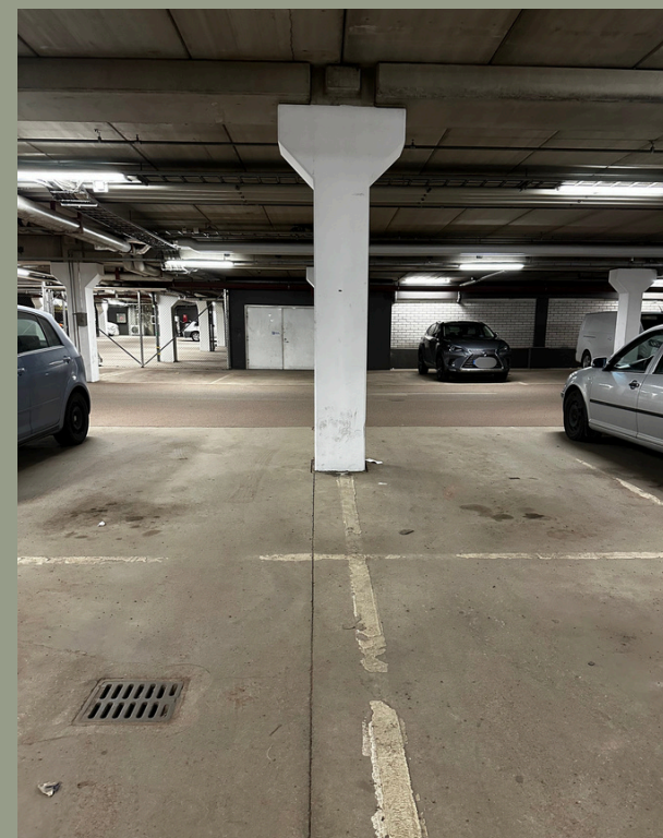
Bild [31]: Inkräktande pelare på parkeringsplats
