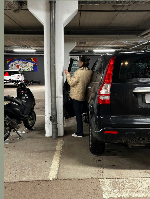
Bild [29]: Inkräktande pelare på dörröppningsutrymmet
